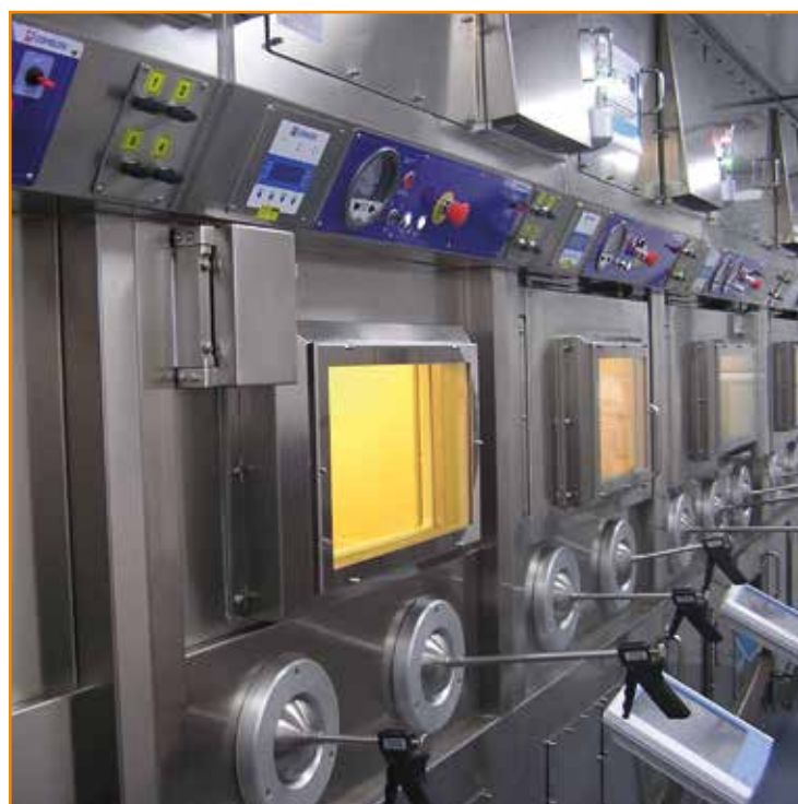
Linia technologiczna do wytwarzania obu prekursorów
